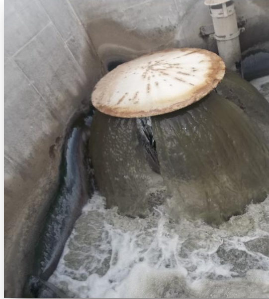
الشكل (III-11): غرفة صرف الغاز.
