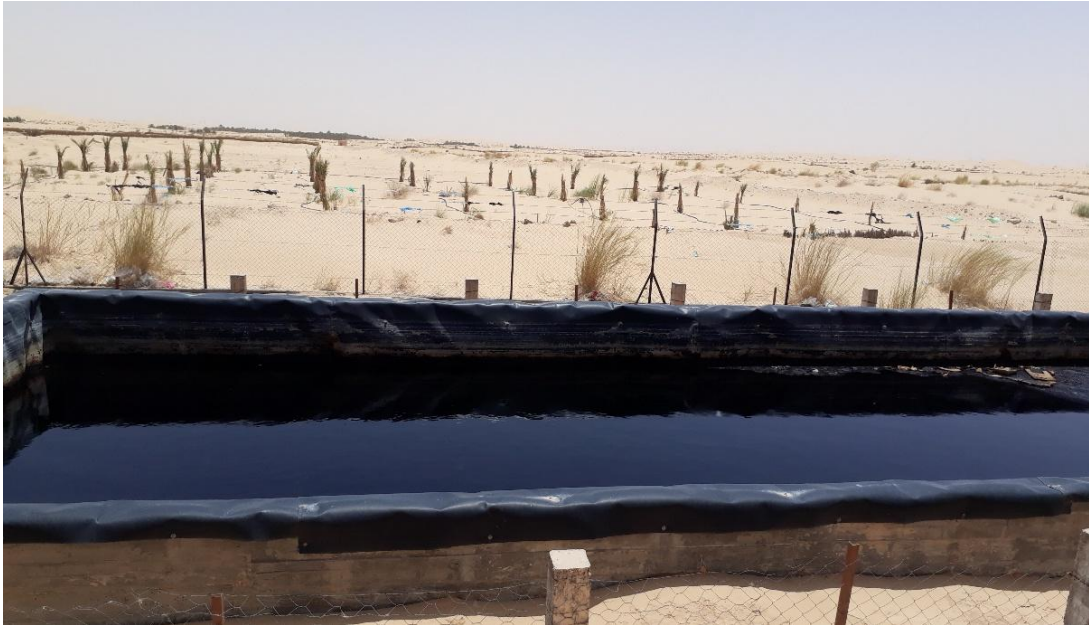
Figure 15 : bassin des lixiviat
