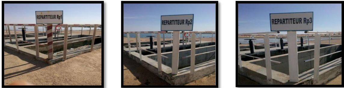
Figure 21 : Répartiteur vers les bassins d'aération (Photo originale, 2022).
