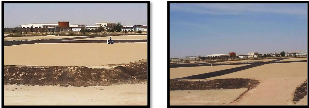
Figure 25 : Lit de séchage des boues (Photo originale, 2022).
