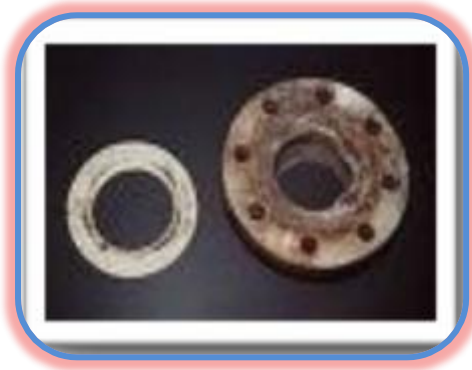
الشكل (6): صورة لتآكل الشقي
