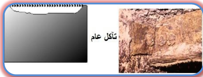
الشكل (2): صورة لتآكل العام
