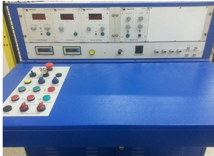
Figure II.3. Panneau de contrôle utilisé pour effectuer les tests.
