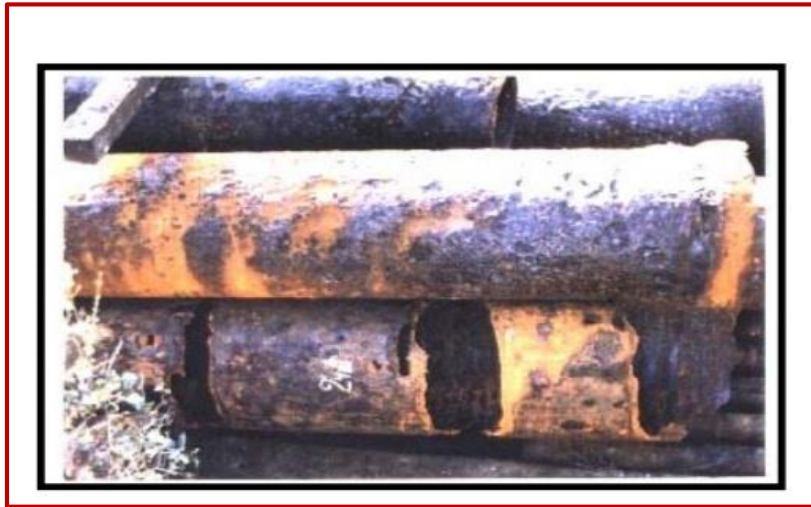
الشكل 14.I: صورة انابيب متآكلة [26]
