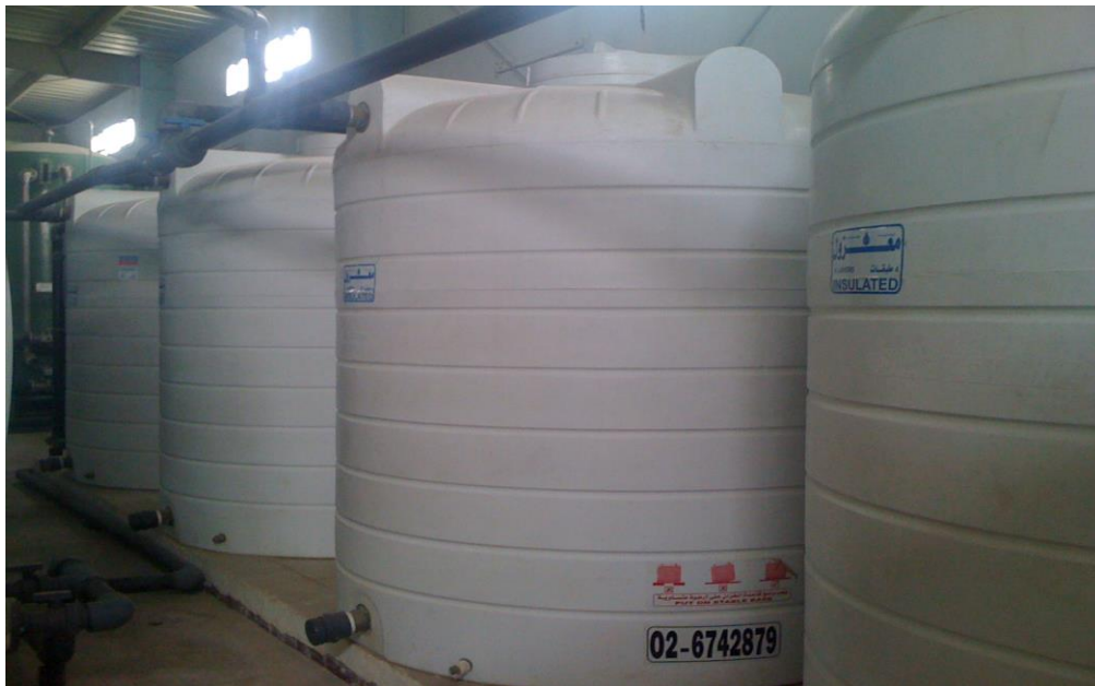
Figure 7: La façon externe des réservoirs.
