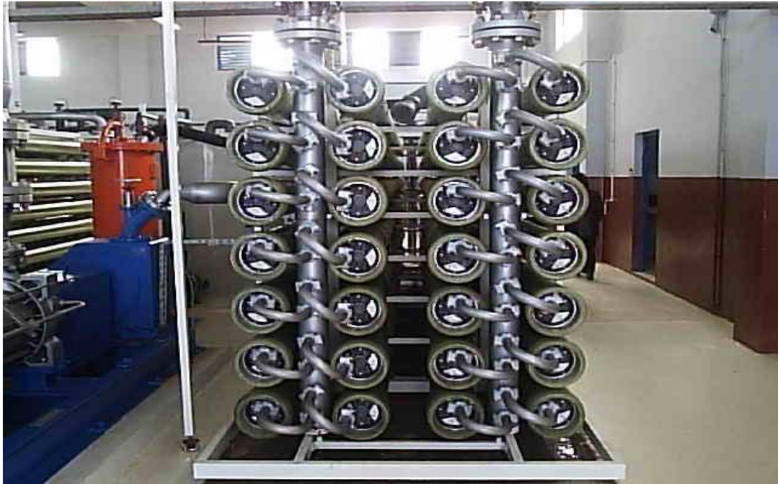
Figure IV.5 : Les modules d'osmose inverse
