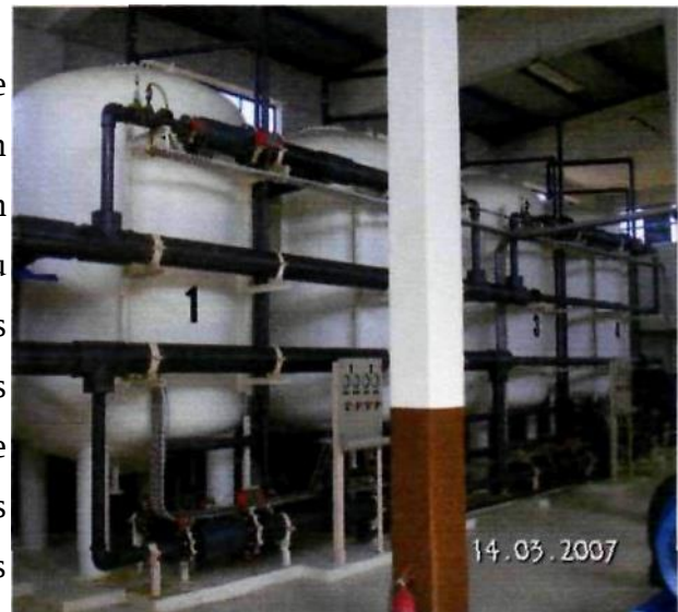
Figure IV.1 : Filtres à sables
