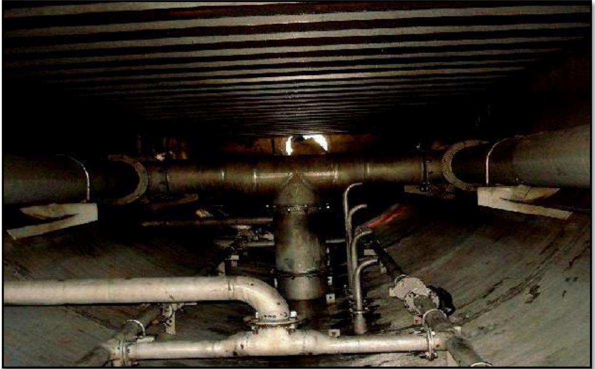
Figure II.10: Intérieur d'un dessaleur électrostatique.
