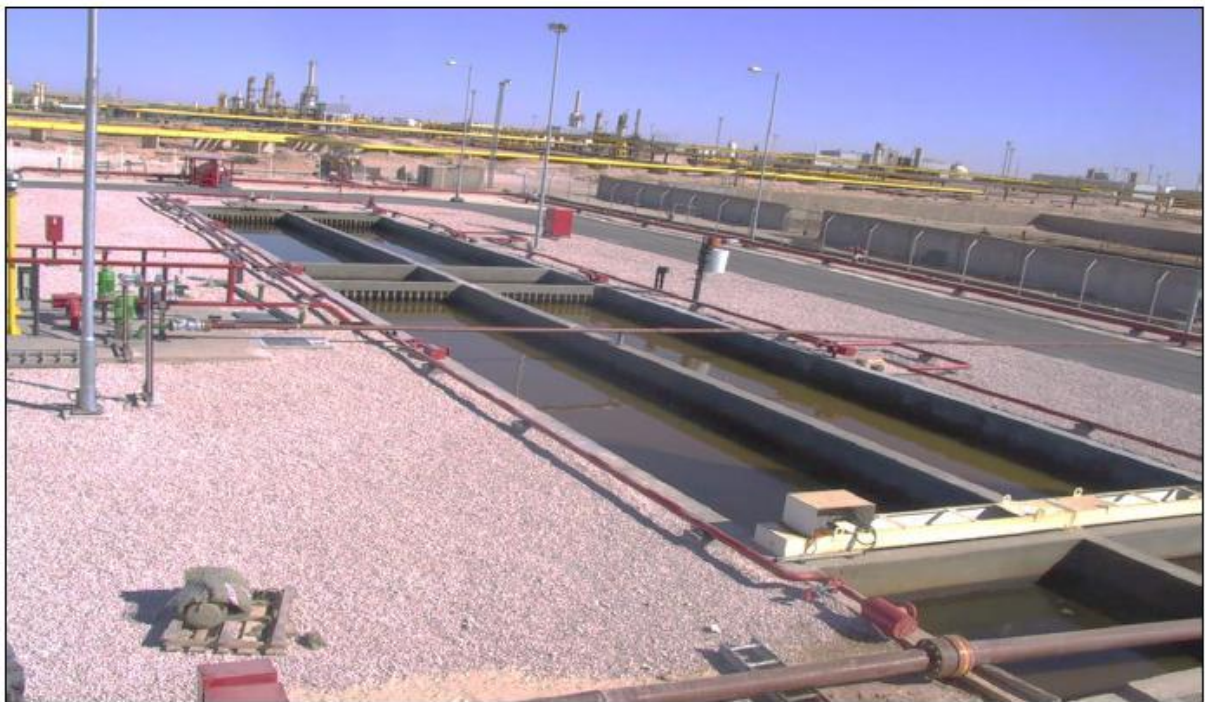
Figure III. 5: Bassin API 2 de l'unité de déshuilage.
