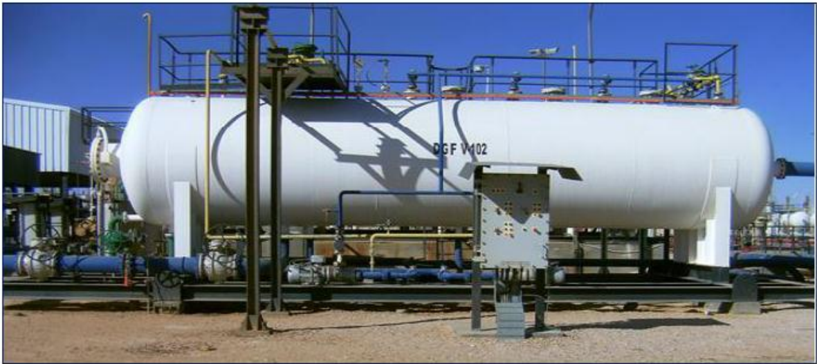
Figure III. 12: Ballon DGF de l'unité de déshuilage.
