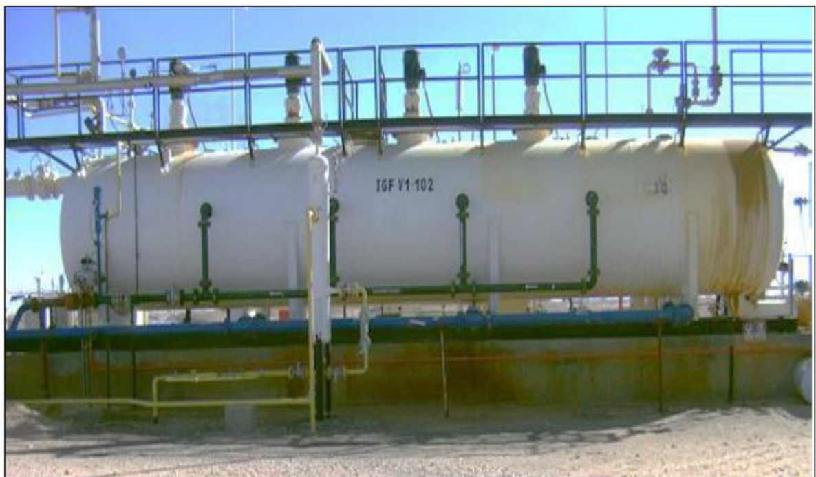
Figure III. 10: Ballon IGF de l'unité de déshuilage.
