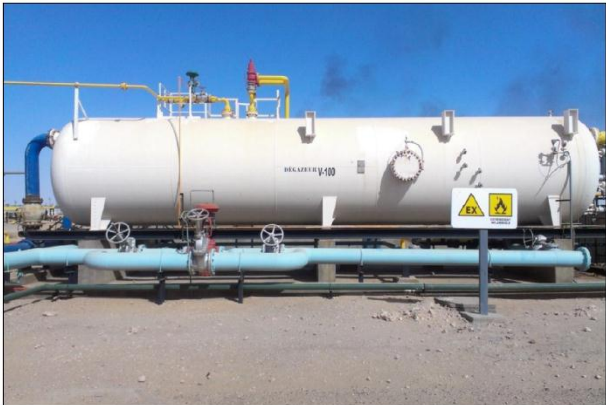
Figure III. 3: Dégazeur de l'unité de déshuilage.
