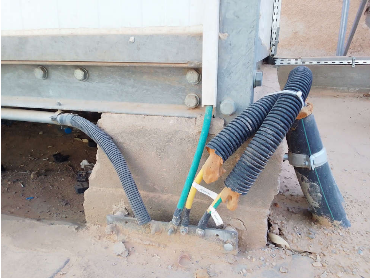
Figure 7 : Mise à la terre d'un pylône de réseaux mobile
