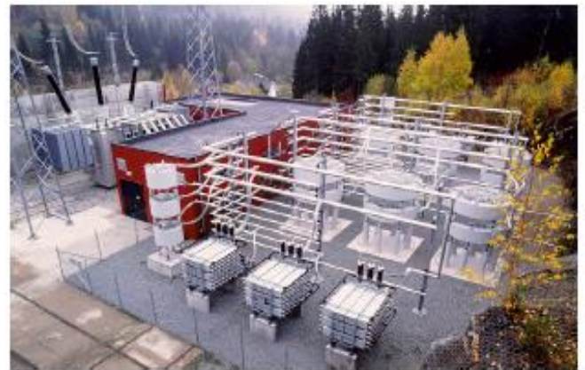
Figure (2-2):SVC installée dans les réseaux
