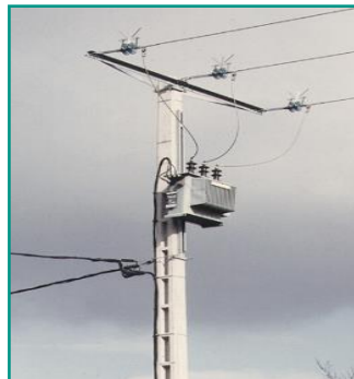
Figure (II-22) : Poste de transformation sur poteau.
