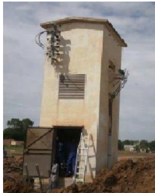
Figure (II-21) : Poste de transformation en cabine maçonnée haute.
