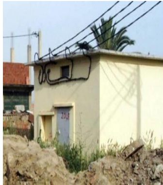
Figure (II-20) : Poste de transformation en cabine basse.
