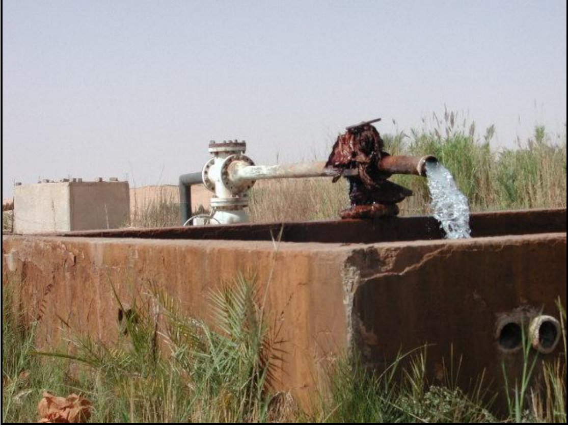
الصورة 05 ضغط الماء في CT
