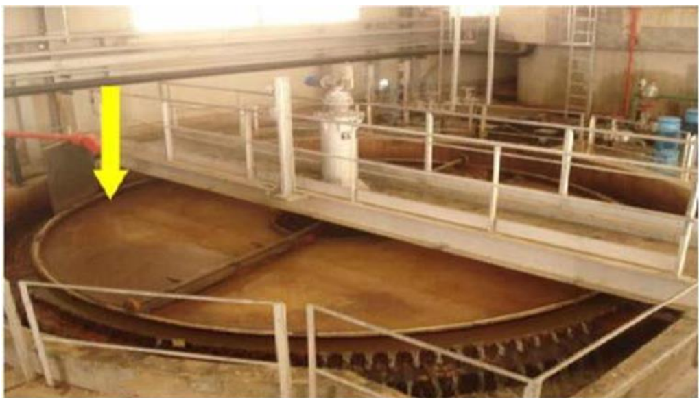
Figure I.9: Cuve d'eau traitée
