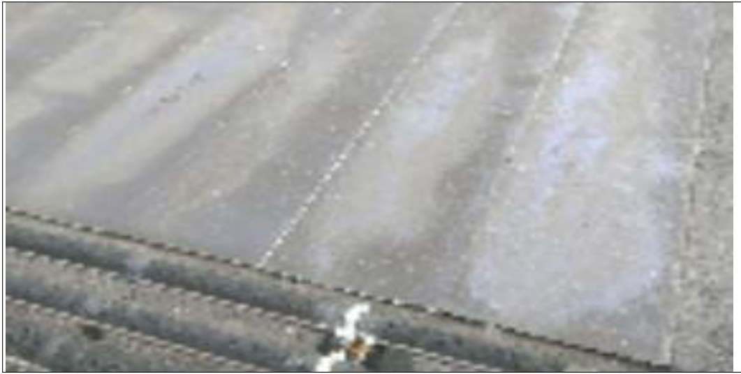
Figure III.20 : Encrassement des Panneaux
