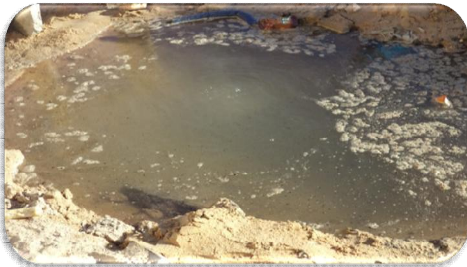
Photo III.2 : Fuite dans Cité 19 Mars
