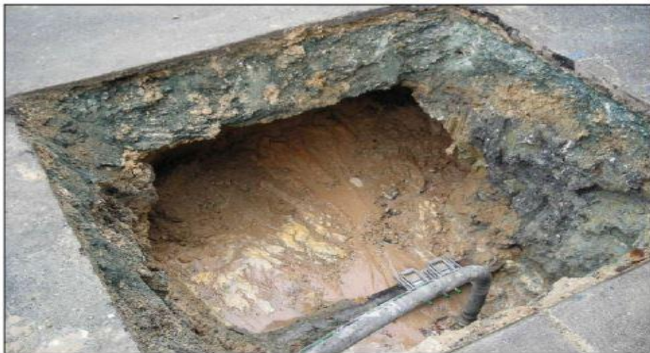
Figure V-5 - excavation générée par une fuite en zone sensible
