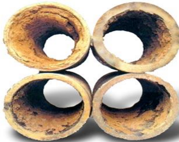
PHOTO N° II-1 : Cas d'entartrage des conduites de distribution
