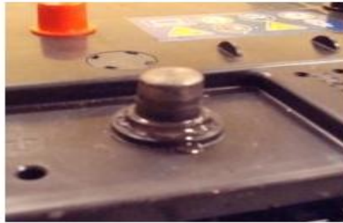
Figure II-20: Fuite d'acide de batterie
