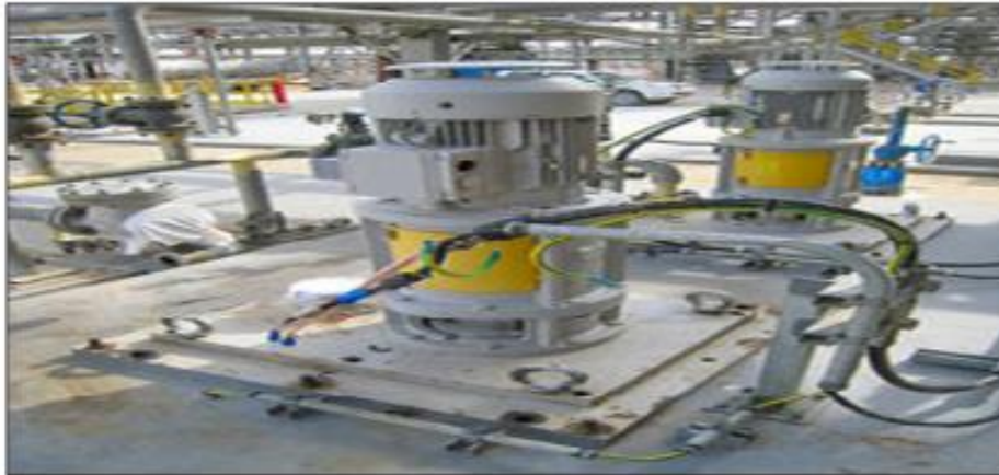
Figure II.9. Station de pompage d'un Oléoduc
