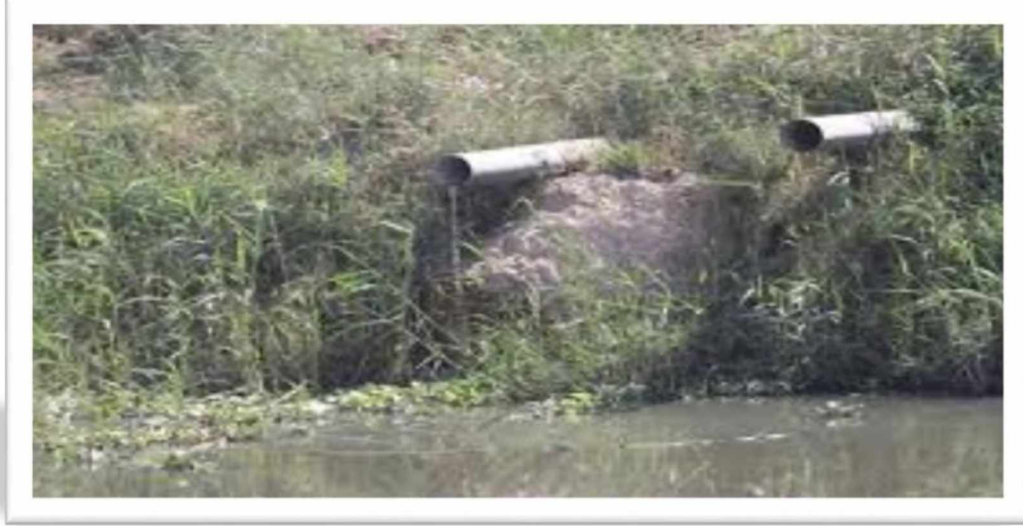
صورة 1: تلوث المياه بفضلات المجاري و مياه الصرف الصحي
