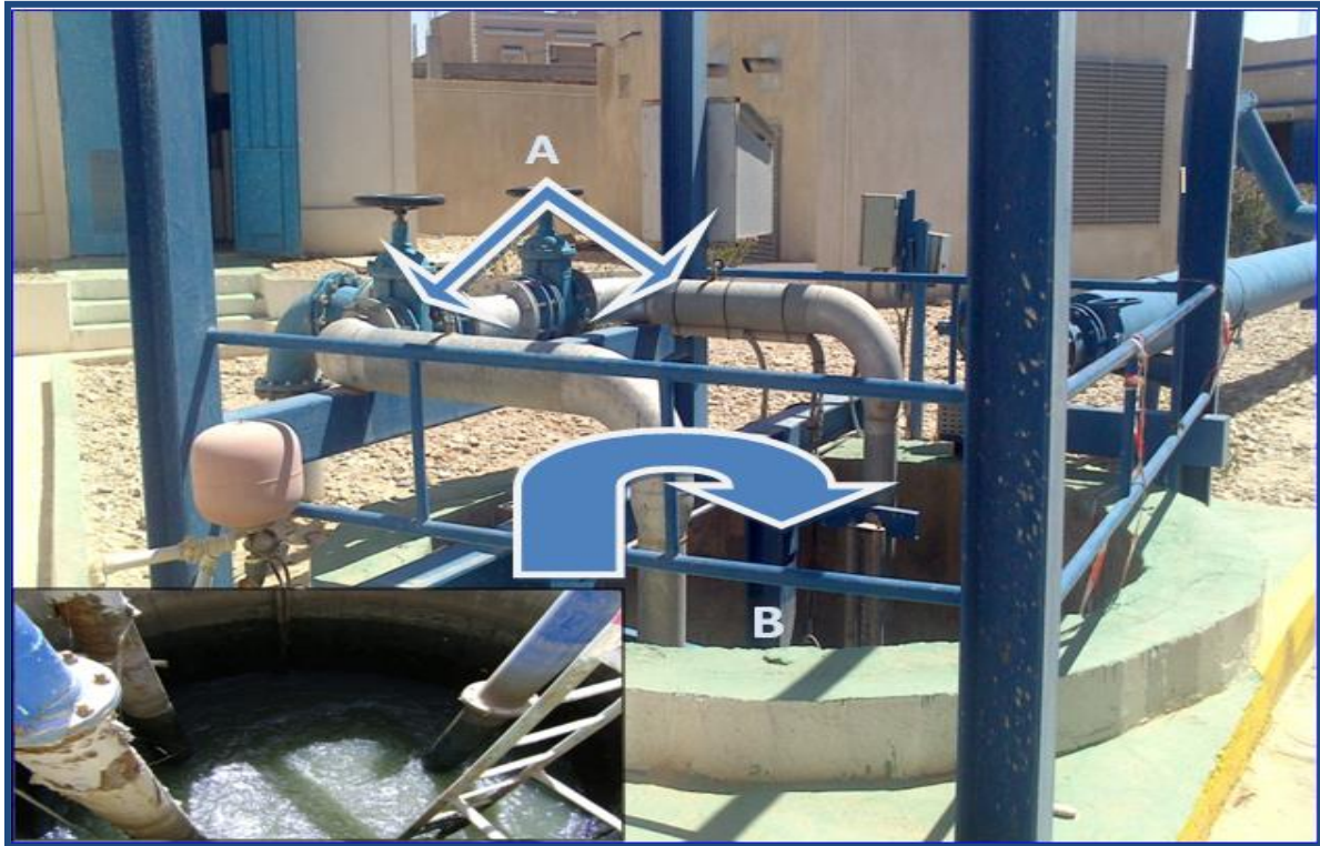
(A) Conduite de refoulement vers le canal de collecte (B) Puits de collecte
