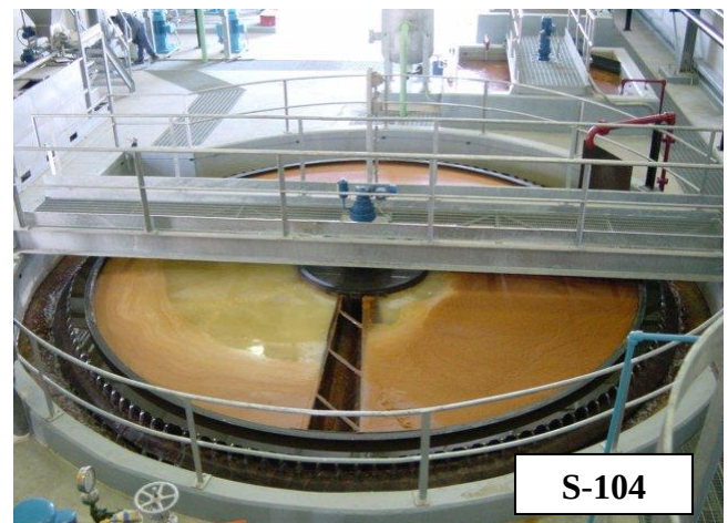
Figure III-15 : cuve de flottation
