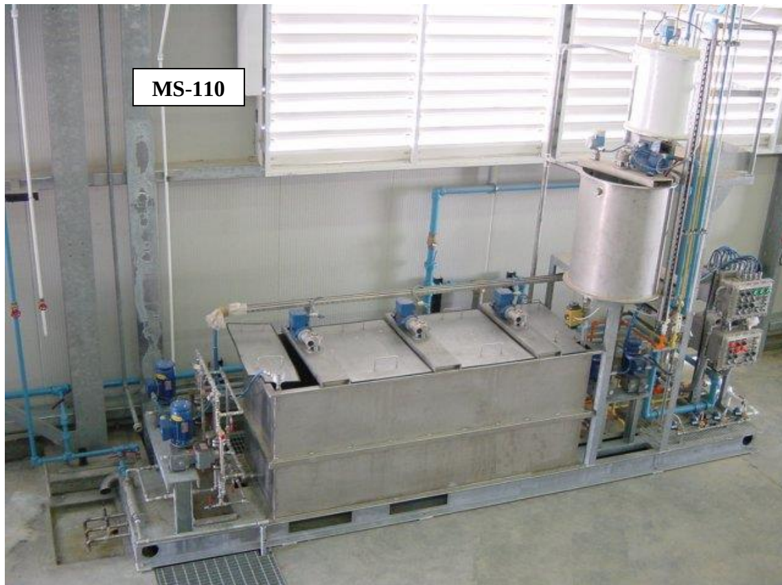
Figure III-23 : Station de préparation et dosage de la silice activée "SILIDOX"
