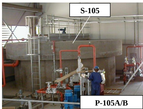
Figure III-20 : Cuve d'épaississement de boues
