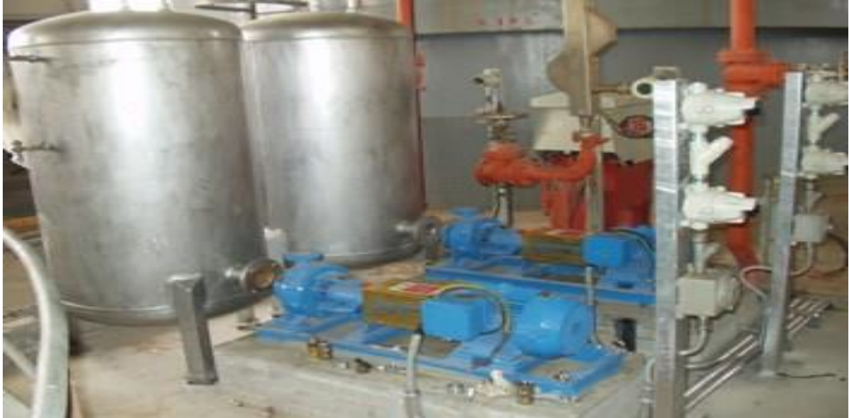
Figure III-19 : pompe de recyclée d'huile récupéré
