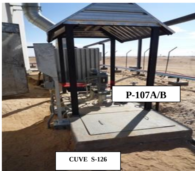
Figure III-12 : drainage des boues
