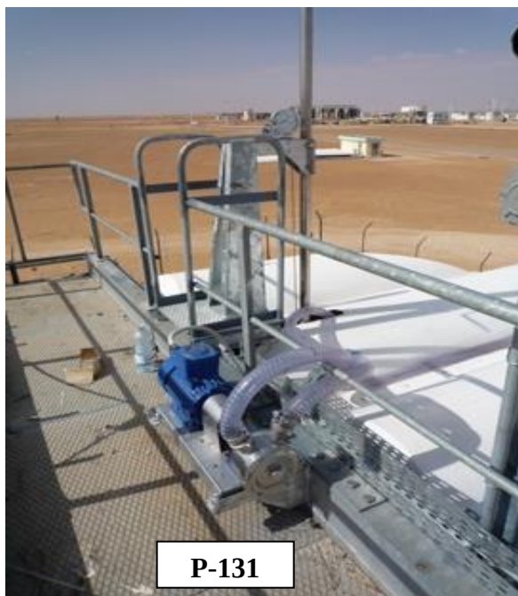
Figure III-8 : pompe derécupération de l'huile
