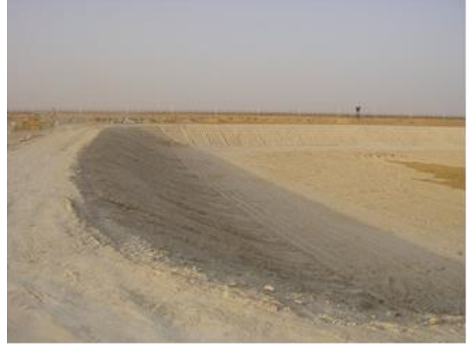
Figure III-3 : bassin non étanche
