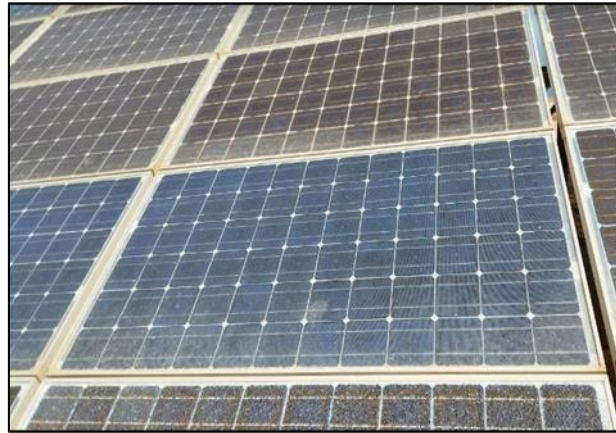
Figure 2.18. Détérioration du revêtement antireflet (ARC)
