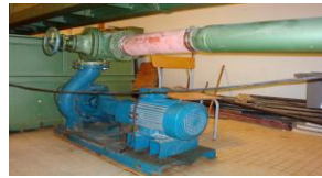
Photo5 : vanne de réglage et pompe
