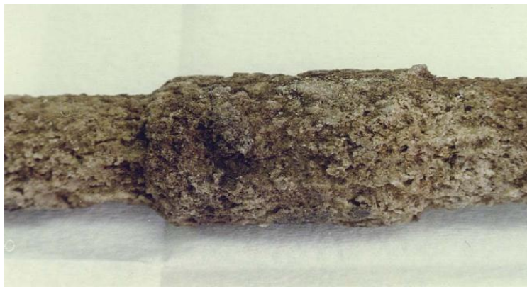
Figure I. 6: Dépôt de sulfate de calcium qui bloquait la surface d'une canalisation au point de connexion [6].
