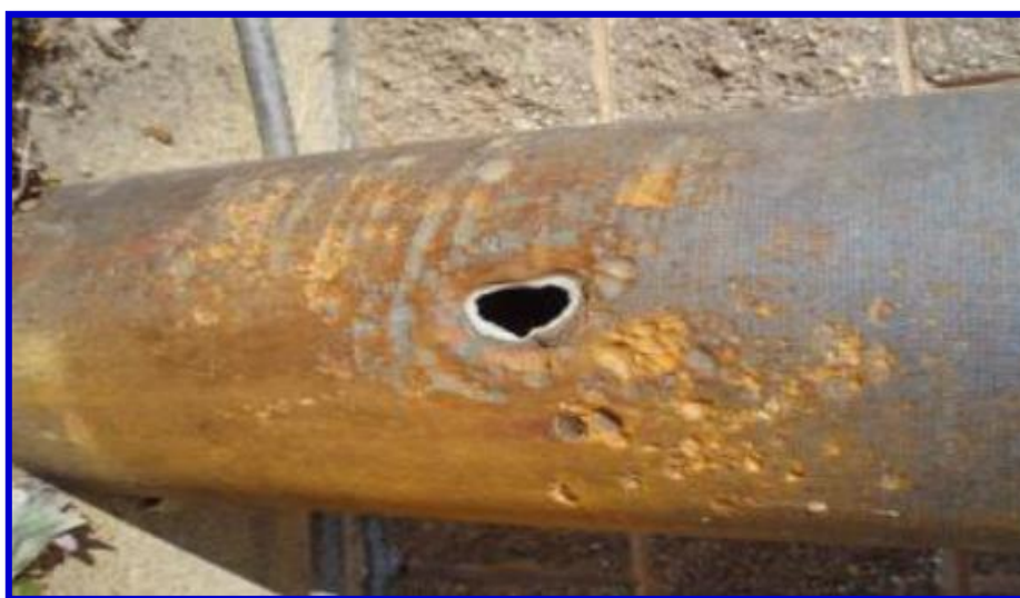
الشكل (7.I): التآكل الموضعي.
