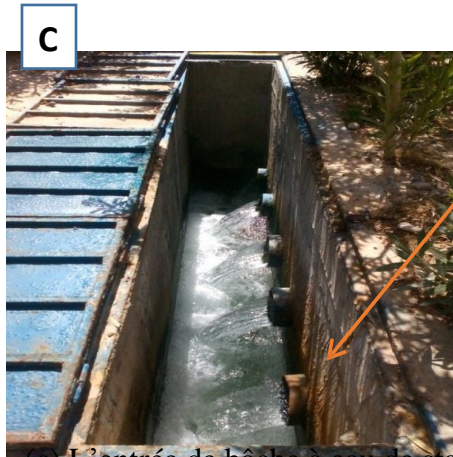
(c) L'entrée de bache à eau de station (ST10)
