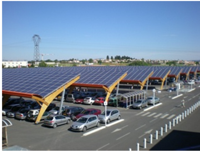
Figure I. 22: Ombrières photovoltaïques à St Aunés (Hérault) [28].
