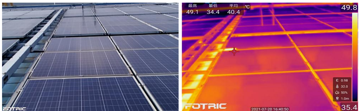
Figure II-14: Défaut Surchauffe des connexions électriques.
