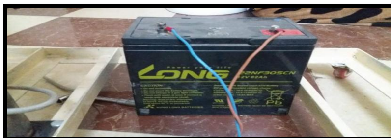
Figure III.14. Batterie du stockage 12V
