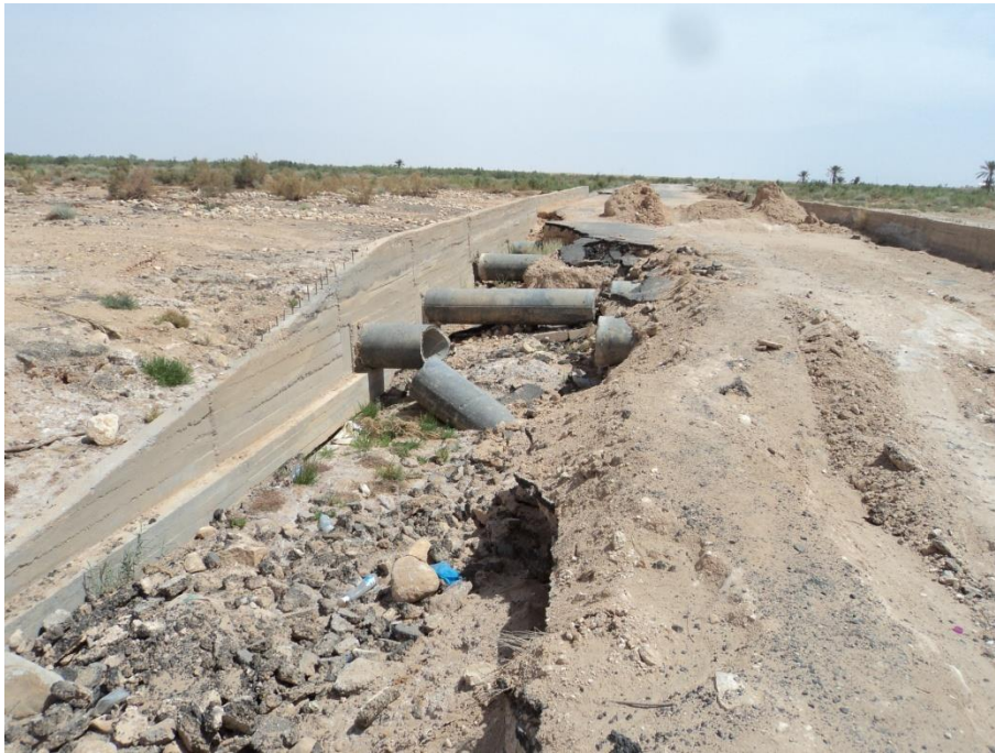
Dégâts au niveau de l'ouvrage de déviation (Séquelle des dernières inondations)
