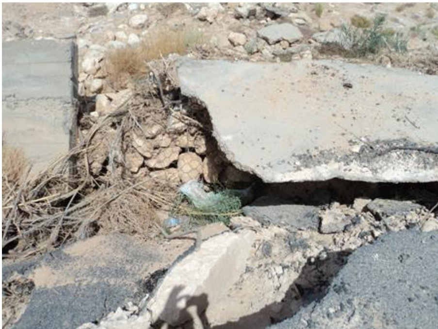
Dégradation des ouvrages et infrastructures existantes (Réseau électrique, route...etc.)
