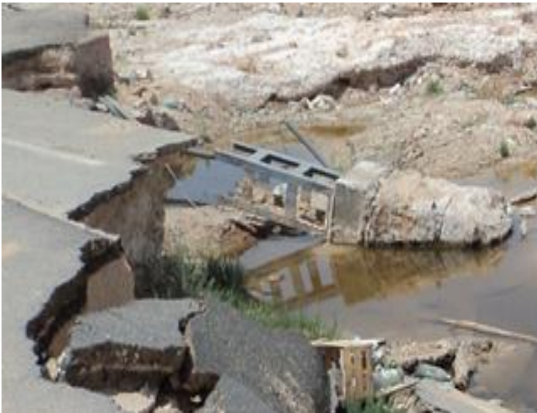
Dégradation des ouvrages et infrastructures existantes (Réseau électrique, route...etc.)
