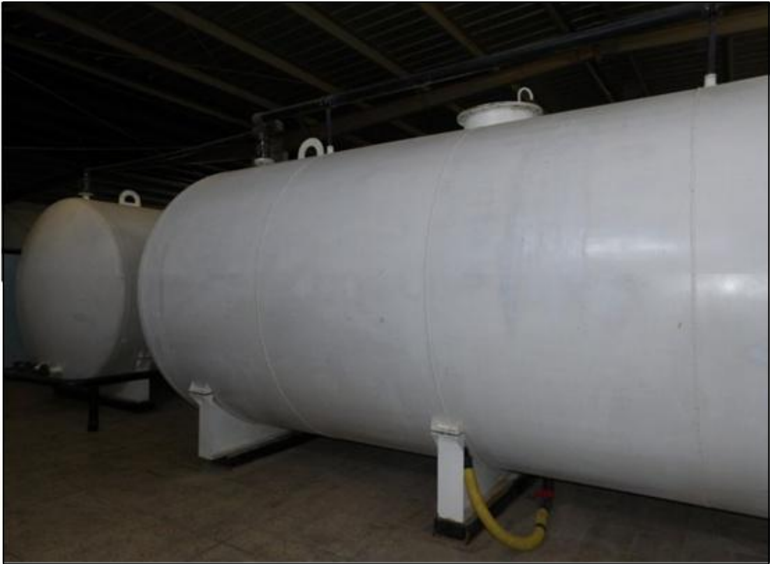
Figure 7 : Les réservoirs pour l'alimentation de la station.
