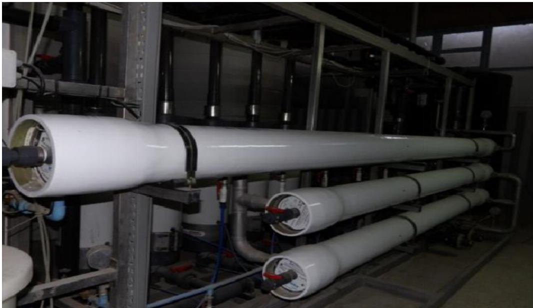
Figure 10 : Les trois modules d'osmose inverse
