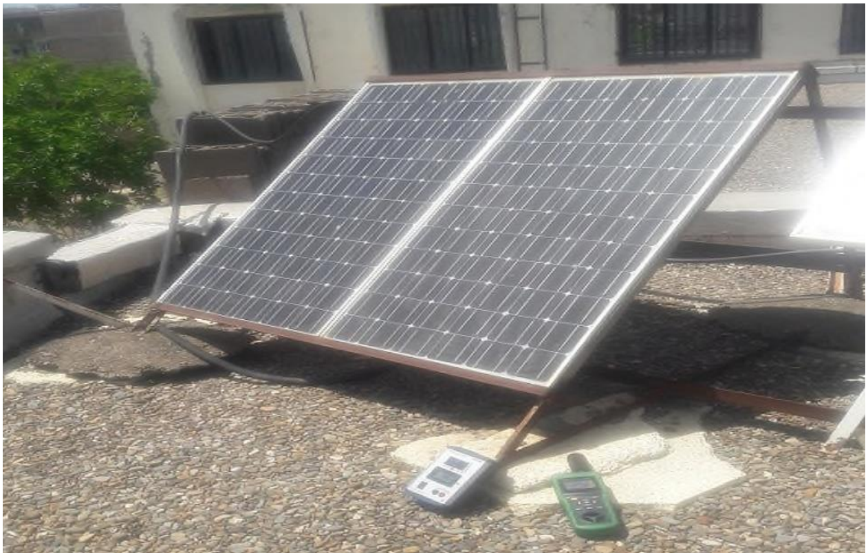
Figure I.21 Un générateur photovoltaïque GPV[23a]
