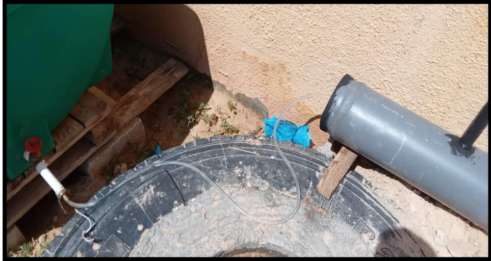
Photo 05 : Alimentation du filtre par l'eau usée (Photo original).
