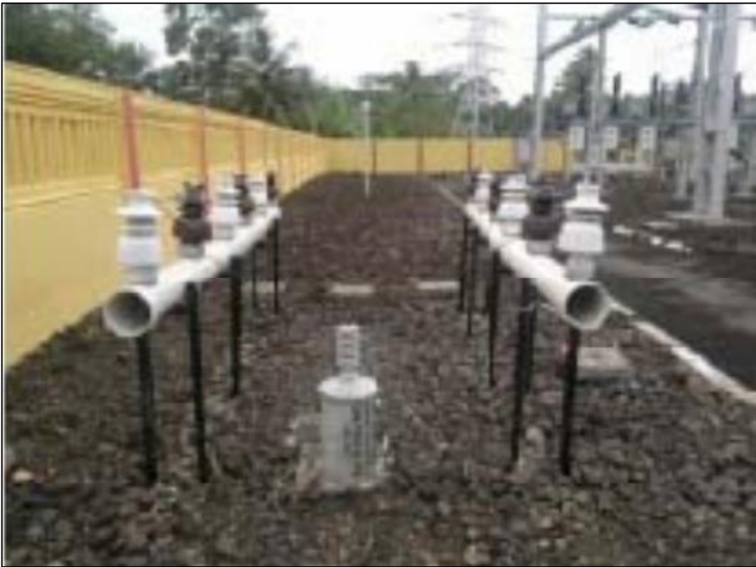
Figure II.16. Les isolateurs à broches de type post ont été installés à la sous-station de Pangandaran.
