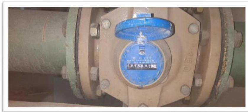
Figure III.5: Débitmètre d'eau dans le canal expérimental.
