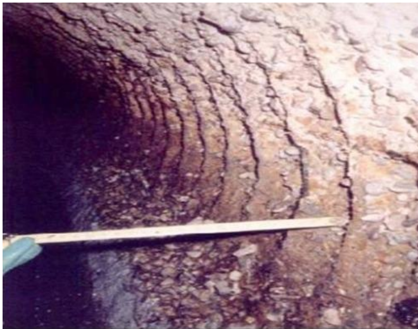
Figure 5.28 : Dégradation par corrosion du béton dans un réseau d'assainissement [12]
