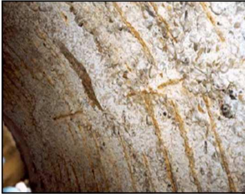
Figure 5.27 : Formation de gypse (couleur blanche) à l'intérieur de la conduite d'assainissement [12]
