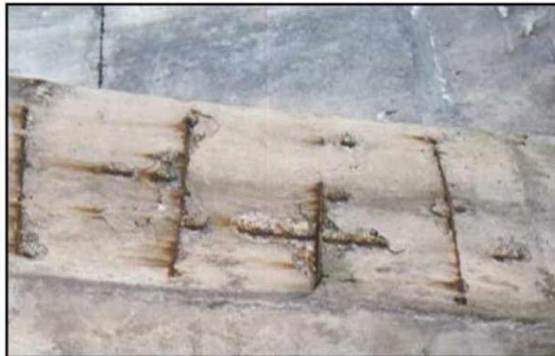
b- Corrosion des armatures.
