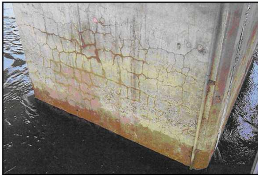
Figure 5.21 : Réseau de fissures dans une pile de pont en contact avec l'eau, endommagée par formation différée d'ettringite [43].
