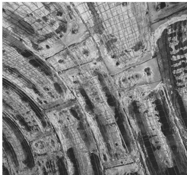
Figure 5.9 : Dommages causés par le feu au revêtement en béton du tunnel sous la Manche.
