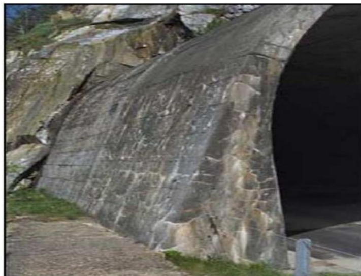
Figure 5.10 : fissurations grossières dues à la réaction alcali-agrégat (Entrée d'un tunnel) [14]
