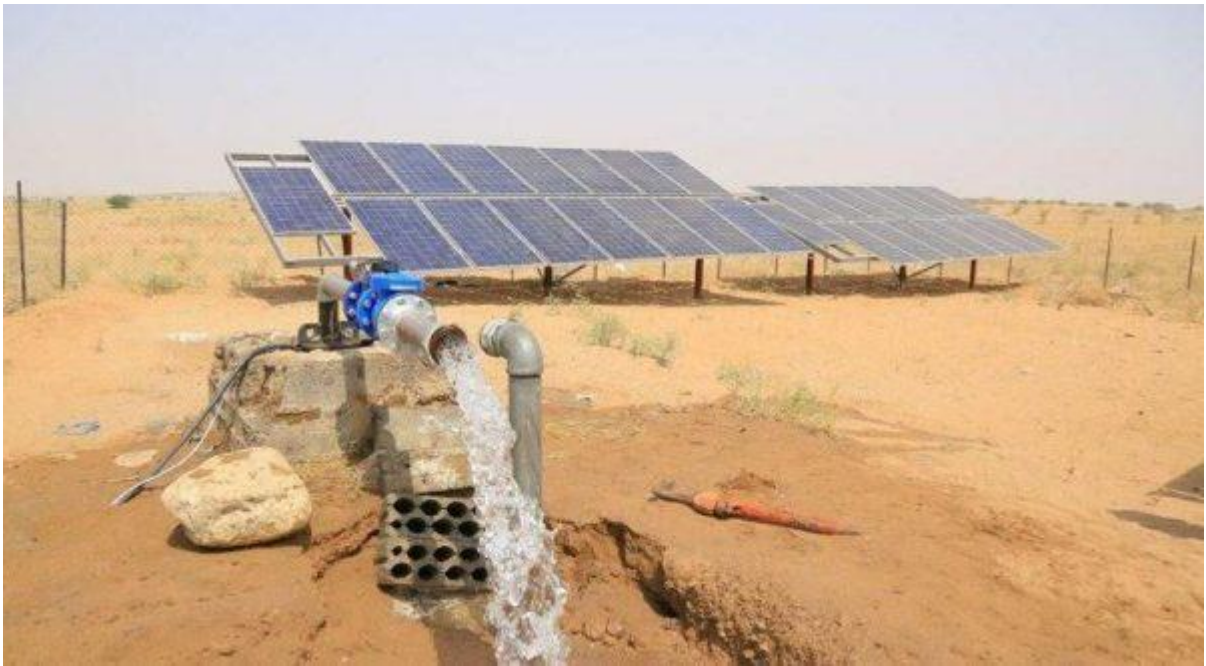
Figure IV1 :. Système pompage PV dans la commune de Ben Guecha W.d'El-Oued
