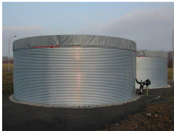
Figure II.21 : réservoir de stockage d'eau
