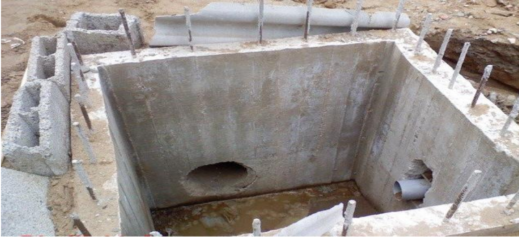
Figure V.2. Regard de visite
