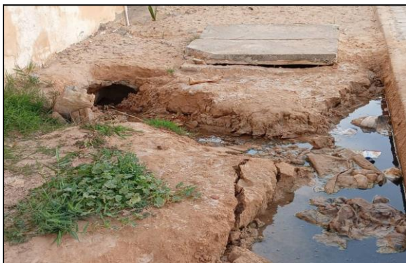
Figure III.9 : Présence des regards d'évacuation des eaux usées dégradés au voisinage des bâtiments.
