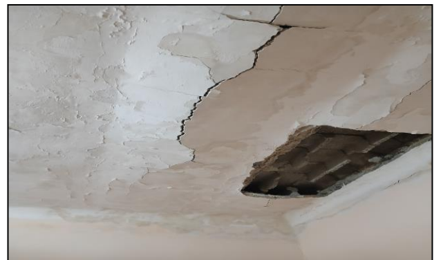
Figure III.8 : Attaque des poutrelles par le chute des parements inferieurs des planchers (corps creux)
