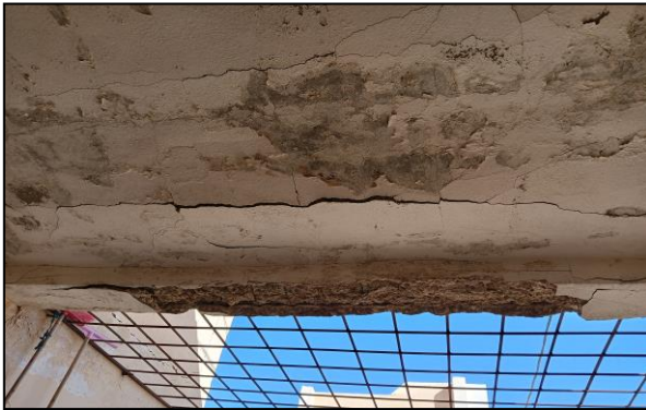
Figure III.7 : Fissures et Gonflement et des parements chlore
