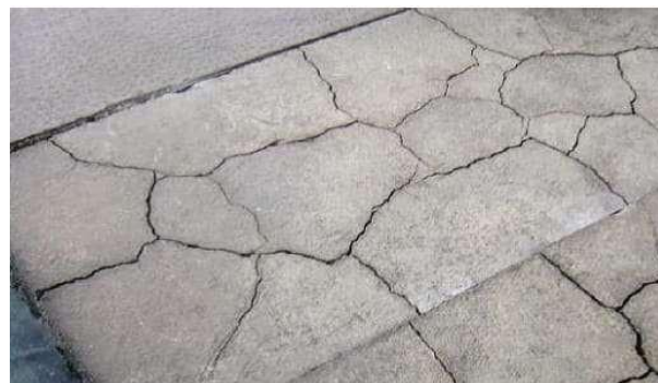
Figure I.3: Dalle en béton fissurée suite à une formation retardée
