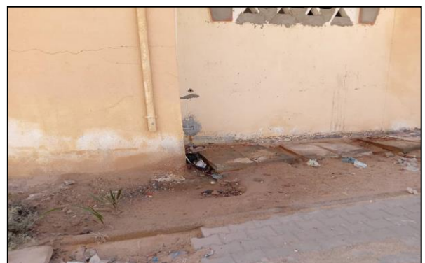
Figure III.12 : Remonter par capillarite de l'agressivité de sol
