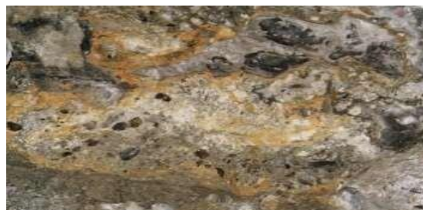
Figure I.4: Efflorescences et de colorations blanchâtres ou jaune de la surface.
