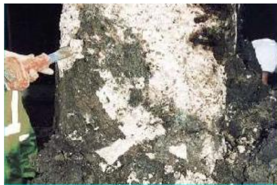
Figure I.7: Destruction complète du béton
