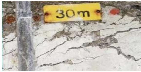
Figure I.5: Fissuration réseau provoquant des éclatements du béton et décollements de la surface.
