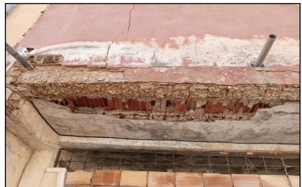
Figure III.10 : Des fuites au niveau de l'alimentation en eau potable et traces liées a la traces liées a la Présence du sel.
