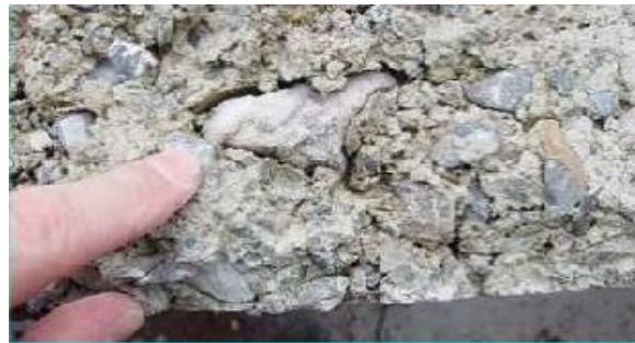
Figure I.6: Fissures dans la masse du béton et décollement entre la pâte de ciment et le granulat.
