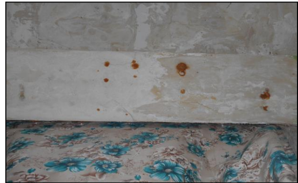
Figure III.5: Appariation des taches mauvaise qualité du béton ainsi le chute de
