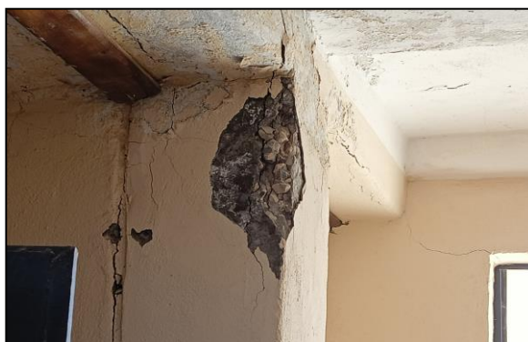
Figure III.11 : Fissures et gonflement de l'enrobage au niveau de la zone nodal poteaux et poutres
