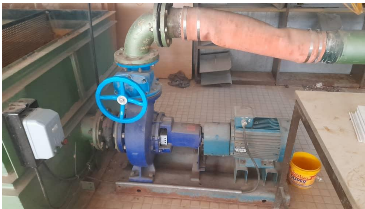
Photo I.2: La pompe utilisée pour générer le débit
