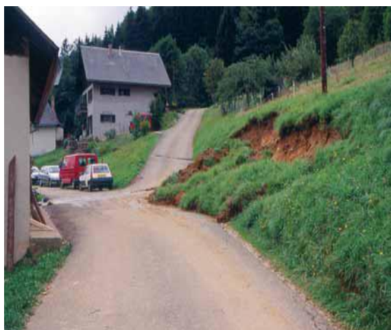
Figure 48 : Glissement de talus - Saint-Pierre-de-Chartreuse (38) 12 août 2002.
