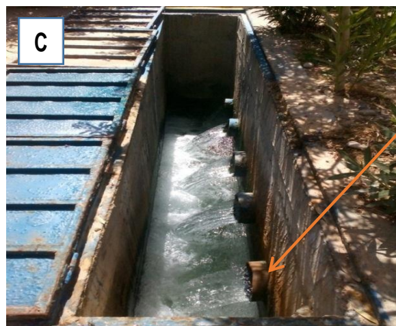
(c) L'entrée de bache à eau de station (ST10)
