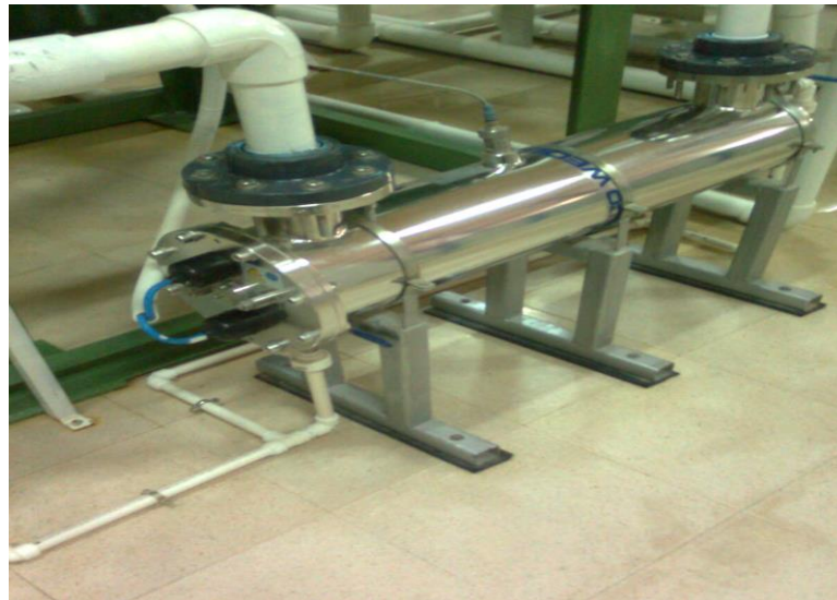
Figure 13: appareil de stérilisation d'eau par UV.
