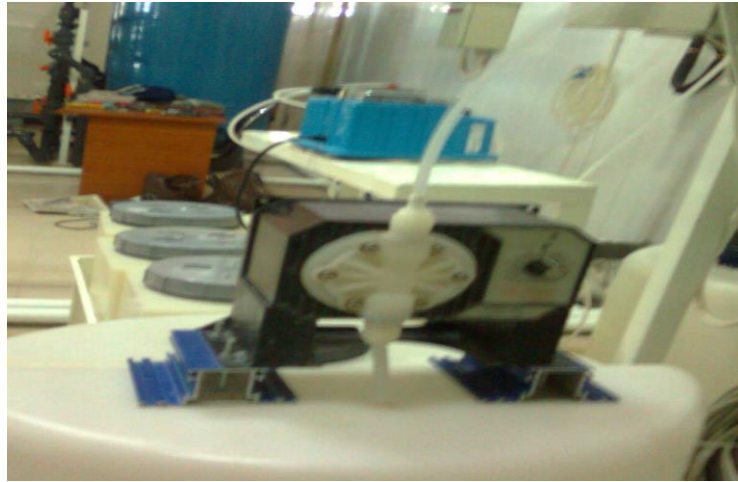
Figure 14:appareil de stérilisation d'eau par le chlore.
