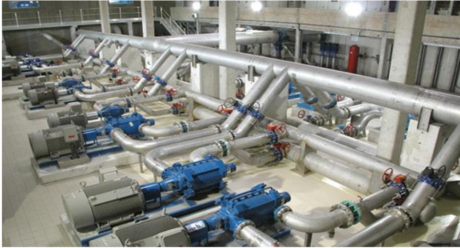
Figure I.5 : Station d'eau traitée [2]
