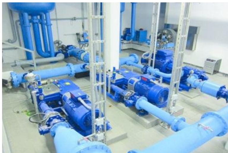
Figure I.1 : Vue globale de la station d'eau brute [2]
