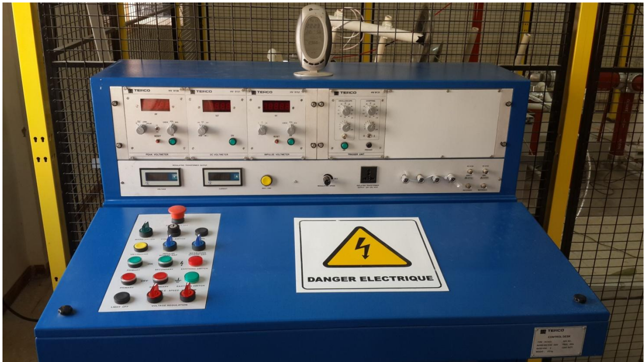
Figure III.1 : Panneau de contrôle utilisé pour effectuer le test de claquage.
