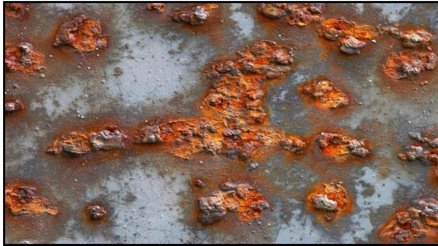
Figure III.7: Photo de la corrosion intergranulaire.
