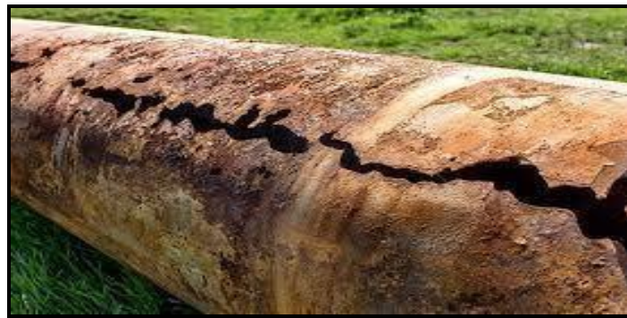
Figure III.14 : photo de la corrosion-érosion d'un tuyau
