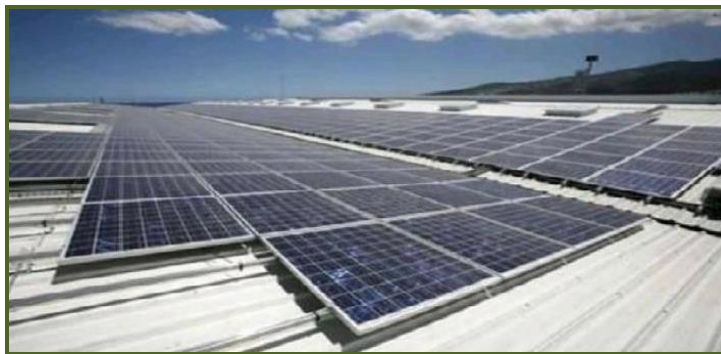
Figure I.5 : Photo d'une centrale solaire.
