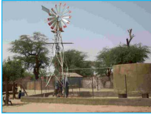
Figure. I.5 Turbine éolienne de pompage - Mauritanie 'lente'
