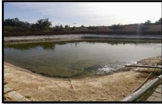
Figure 17 : Réservoir de stockage des eaux usées issues de la pisciculture.
