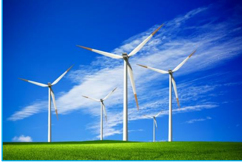
الشكل (2-I): صورة فوتوغرافية توضح حقل توربينات لطاقة الرياح.
